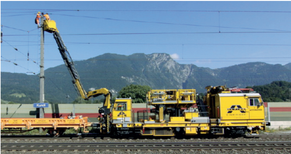
Abb. 7: Oberleitungsspezifische Einrichtungen des MTW 10
