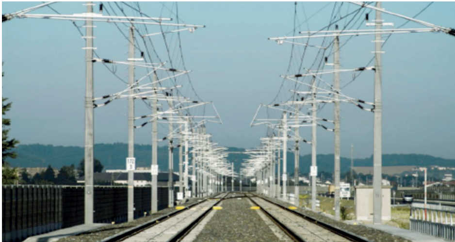
Abb. 2: Oberleitungsanlagen für 250 km/h für die freie Strecke
