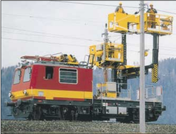
Abb. 8: MGW 10 mit dreigeteilter Hebebühne
