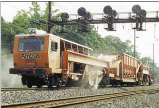
Abb. 4: Ballast Management System mit zwischengeschalteter Material-Förder- und Siloeinheit zur erweiterten Materialaufnahme
