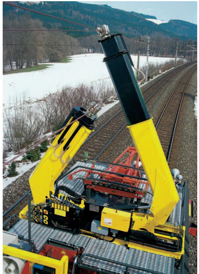
Bild 10: Fahrdraht- und Tragseildrückanlage.
