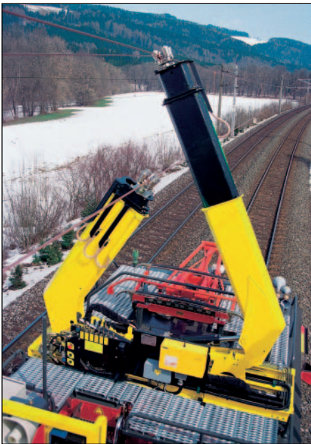
Abb. 5: Arbeitssituation – Fahrdrabt- und Trageildrückanlage
