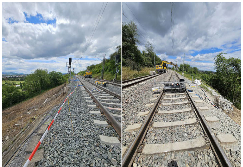
Abb. 1: Von Starkregenereignis betroffener Streckenabschnitt, welcher mit dem Georadar untersucht wurde
