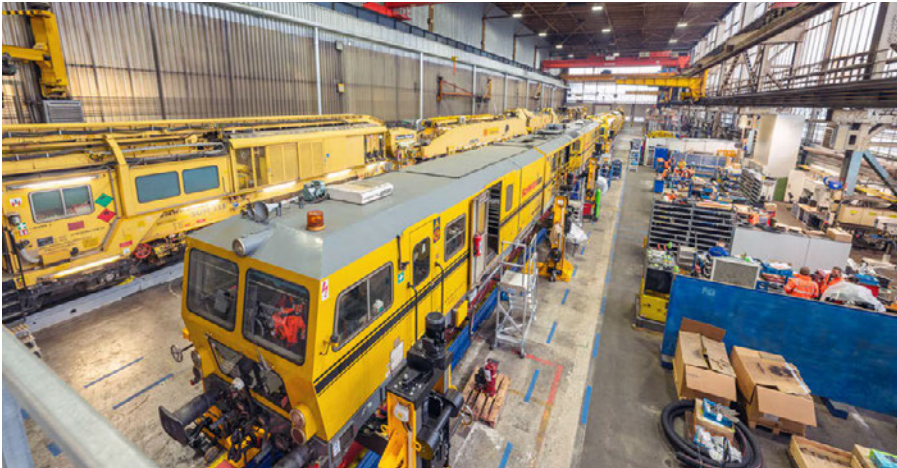
3: Die LCS-Halle im Stammwerk Linz verfügt über sämtliches Equipment, um bei Maschinen aller Typen sämtliche Wartungsarbeiten durchführen zu können. Die räumliche Nähe zu den Konstruktionsabteilungen bringt den zusätzlichen Vorteil, im Bedarfsfall auf konstruktives Know-how zugreifen zu können
