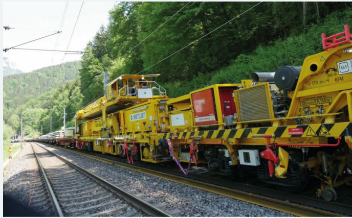
Bild 11: Portalkräne für den Zu- und Abtransport der Alt- und Neuschwellen und Schwellenwagen mit einem neu entwickelten Entgleisungsschutz
