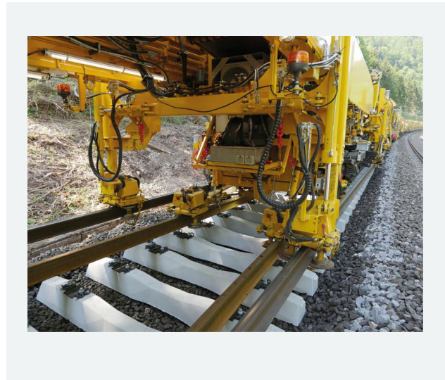
Bild 2: Gleichzeitige Erneuerung der Schienen, Schwellen und des Schotters in einer Baulücke von nur 6 m
