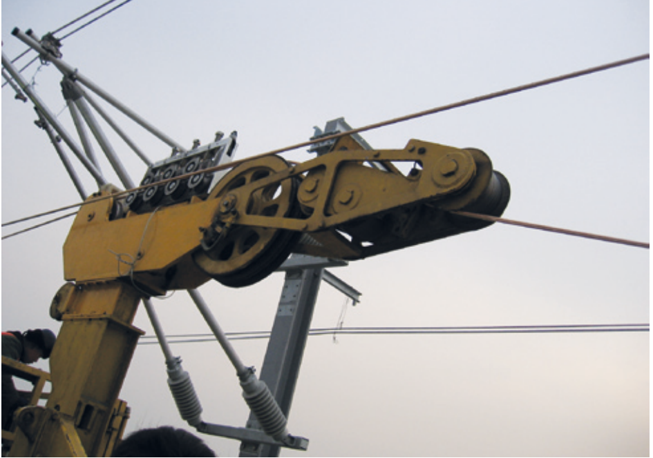
Abb. 6: Unzulängliche Montagetechnik – Biegung des Fahrdrahtes entgegen der natürlichen Trommelkrümmung im Projekt Beijing – Tianjin (China), Kompensation durch Rollenrichtgerät (nkt)
