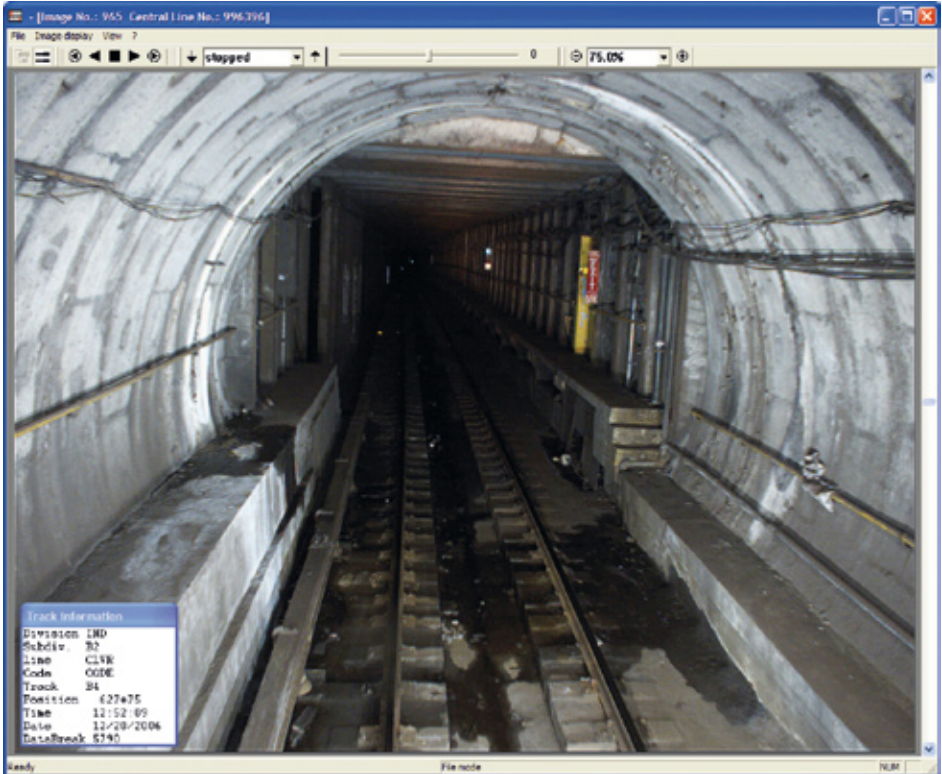
Abb. 7: Die Verwendung des Hochleistungs-Tunnelwandbeleuchtungssystems ermöglicht eine Nutzung des Videosystems auch in nicht oder schlecht beleuchteten Streckenabschnitten.
