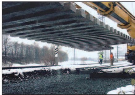
Abb. 9: Gefahren durch schwebende Lasten
