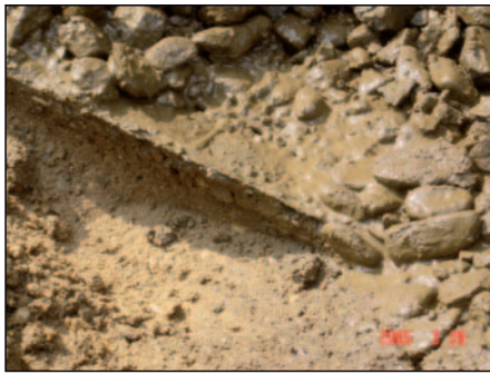
Abb. 2: Schlamm im Schotter auf Grund mangelnder Entwässerung
