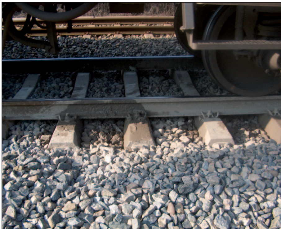
Abb. 1: Spritzstelle im Schotterbett
