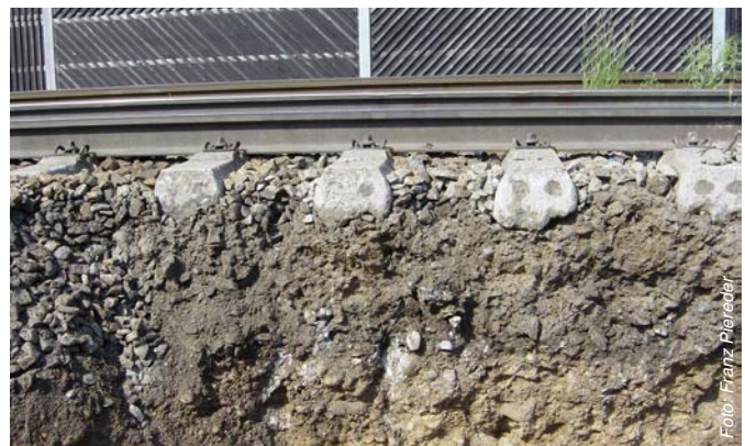
Auswirkung eines verschmutzten Schotterbettes
