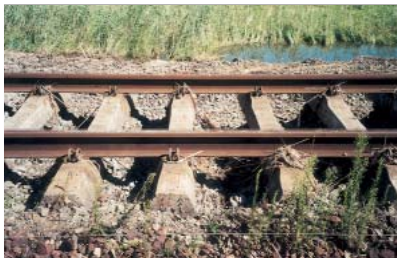
Bild 1: Hochwasserschaden an der Strecke Auschwitz—Zatow
