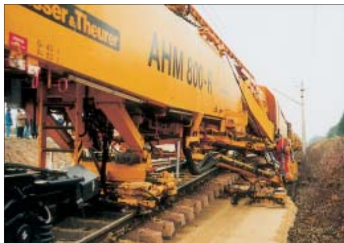
Bild 4: Anheben des Gleisrostes und Einbau der neuen PSS mit der AHM 800-R PL
