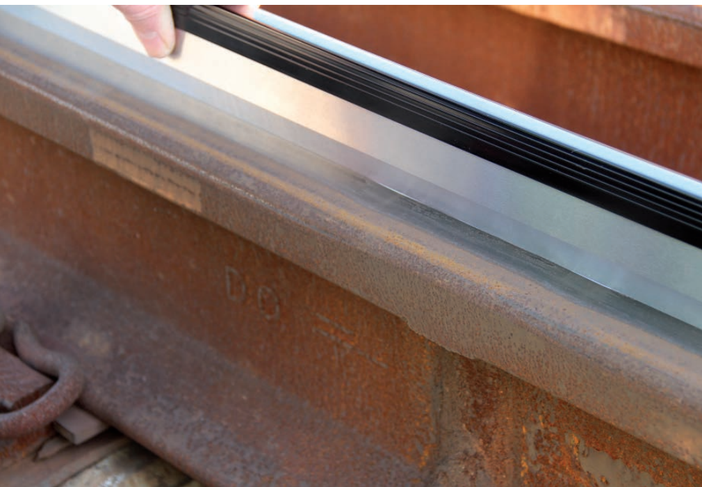
BILD 2: Durch Verschleiß bedingte Dellen in der Weichglühzone einer aluminothermischen Schweißung (Quelle: ÖBB)
