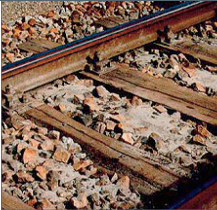
BILD 7: Schlamm- und Spritzstellen an der Bettungskrone
